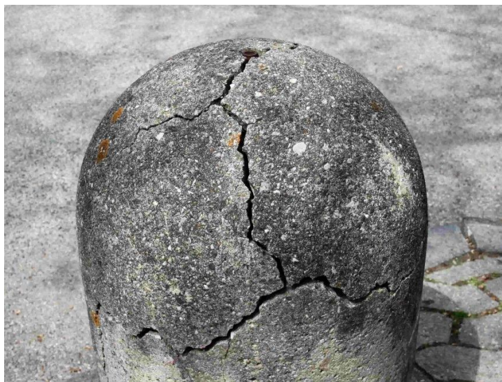
تخریب ناشی از هوازدگی بتن
