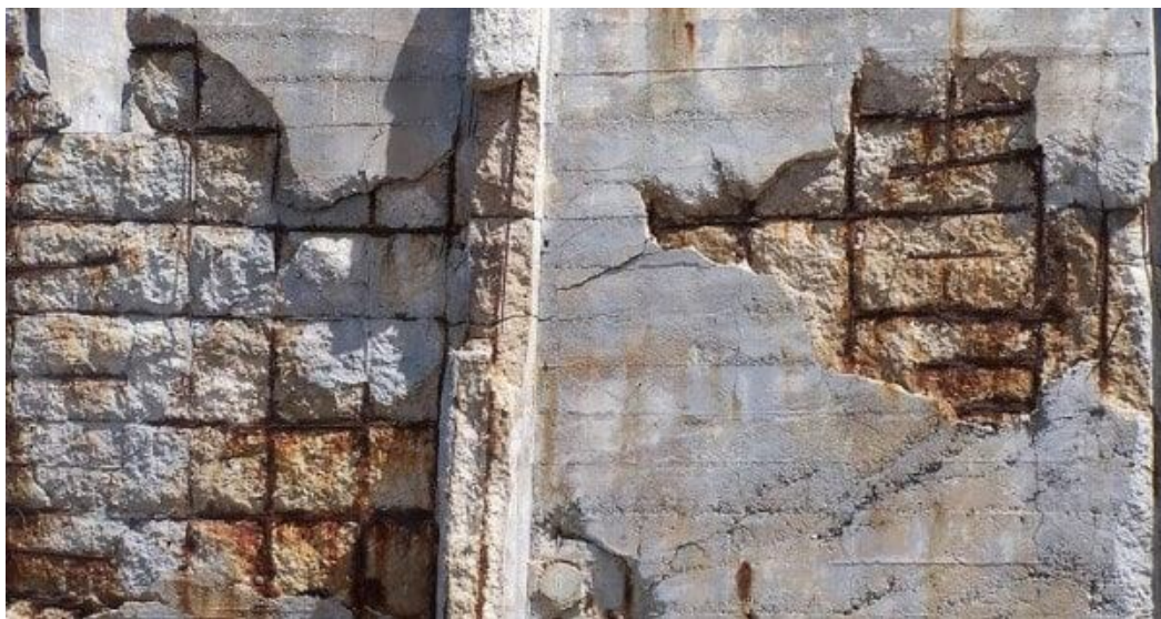
تخریب بتن ناشی از حملات مخرب
